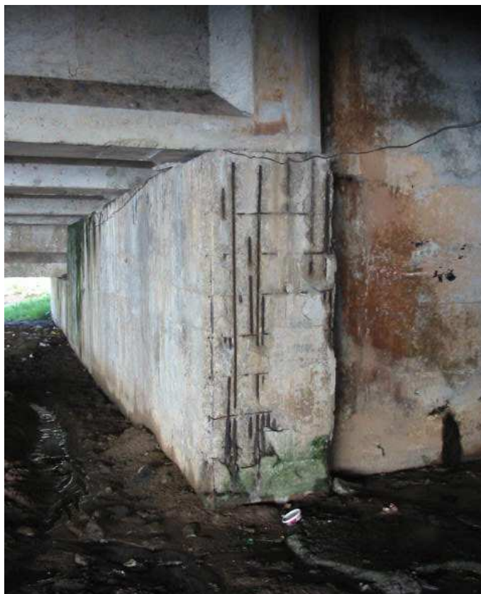
Figura 2.6 – Corrosão iniciada por íons cloreto em pilar da Ponte de Igapó em Natal – RN.
