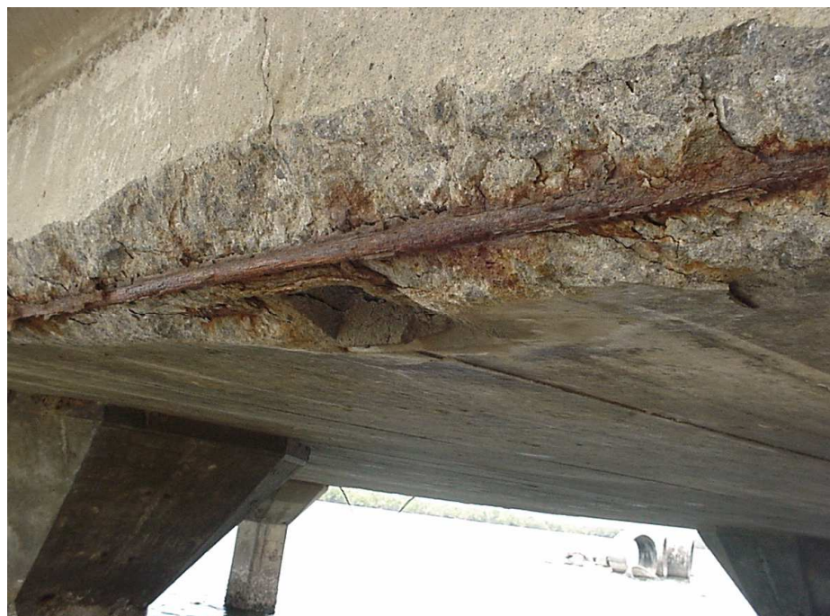
Figura 2.7 – Armaduras de ponte em avançado processo de corrosão iniciada por carbonatação e íons cloreto.
