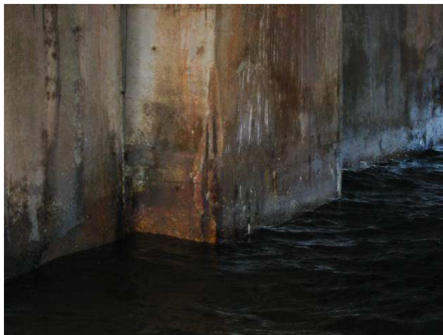
Figura 2.8 – Pilar em ponte com manchas marrom-avermelhadas ou alaranjadas, indicando à presença de corrosão das armaduras.
