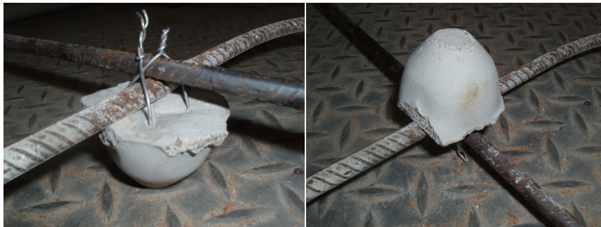
Figura 2.13 – Situação final da pastilha, travada na armadura.
