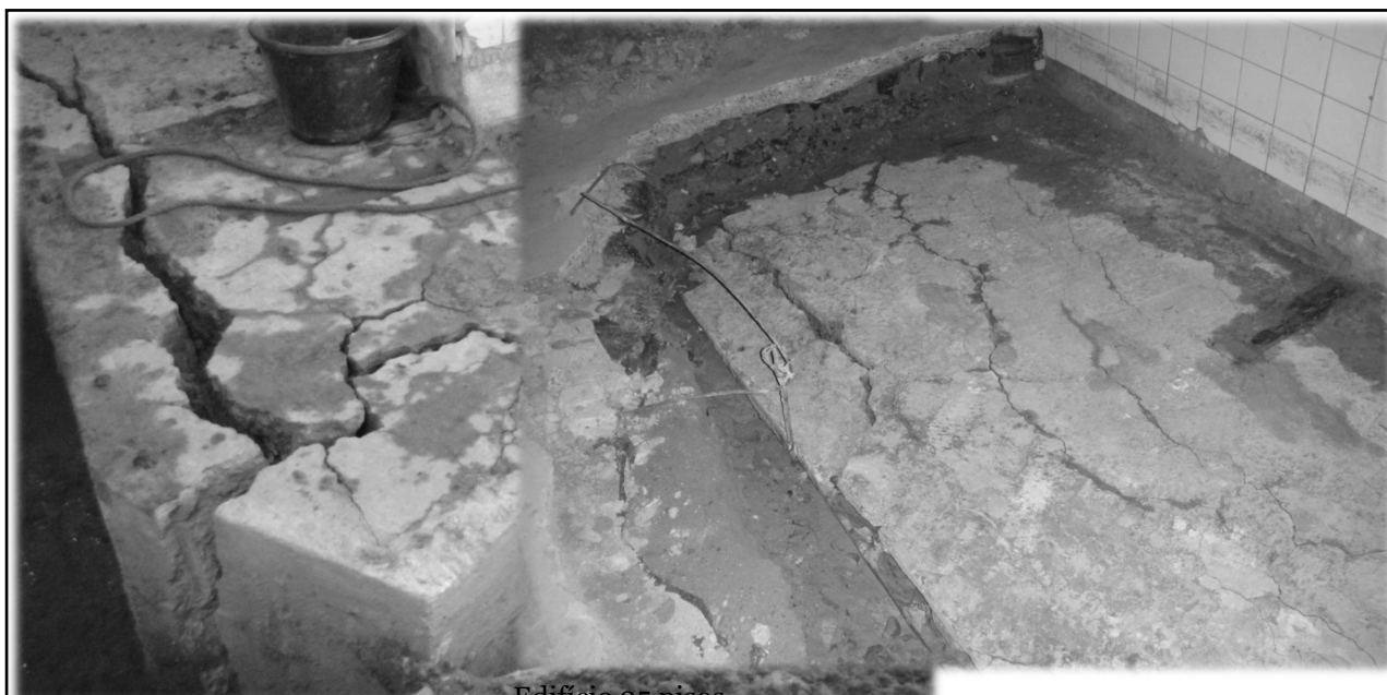
Edifício 25 pisos Diagnosticado 2011 Idade: 2 anos
