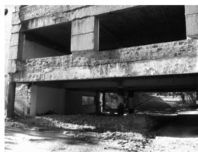
Viga com altura insuficiente para o vão.
