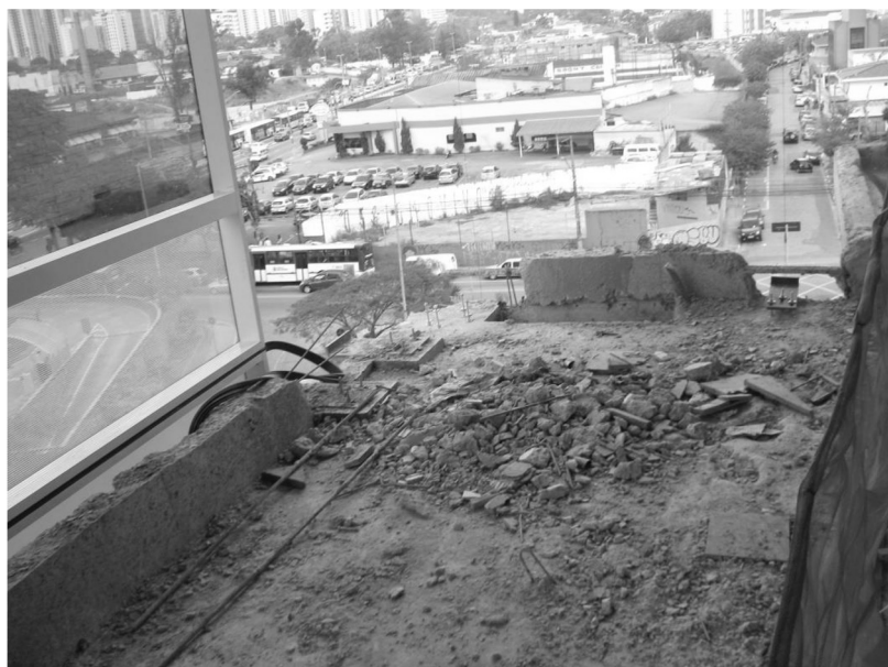
Vigas sendo Demolidas e Cortadas suas Armaduras sem Consentimento do Projetista
