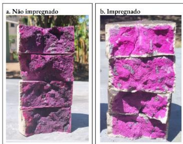
Figura 47 - Área de frente de carbonatação no concreto de traço 0.65 no período de T90.
