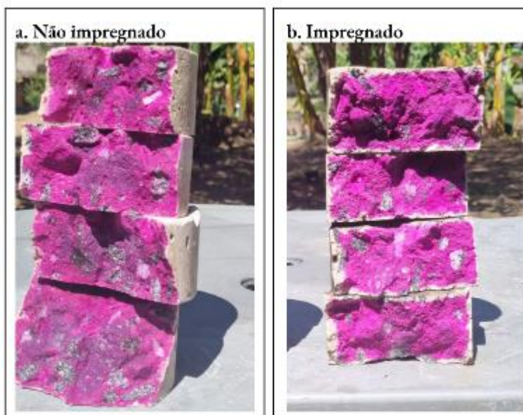
Figura 37 - Área de frente de carbonatação no concreto de traço 0.55 no período de T90.
