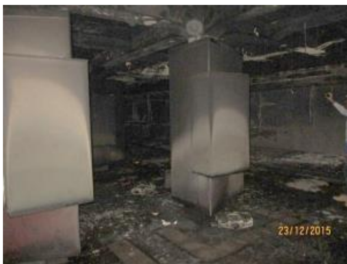
Figura 4 – Estrutura do museu da língua portuguesa não danificada pela ação da temperatura, contudo completamente impregnada por fuligem.
