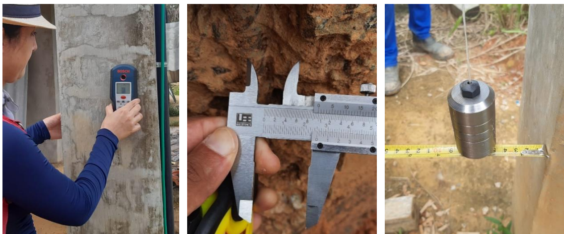
Figura 9. Detalhe da localização das armaduras (à esquerda), verificação das bitolas (figura central) e constatação do desaprumo evidente de um pilar principal (à direita).
