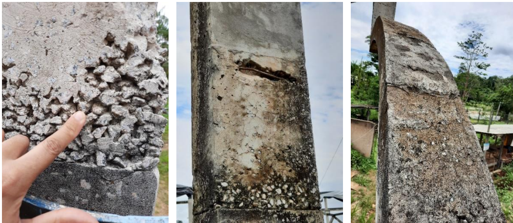
Figura 8. Elementos estruturais que apresentam falhas de concretagem provavelmente oriundas de lançamento e adensamento inadequados.
