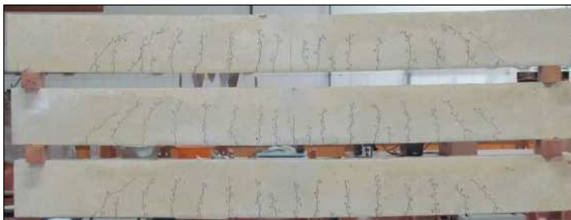
Figura 3.14 – Fissuração em conjunto de vigas.
