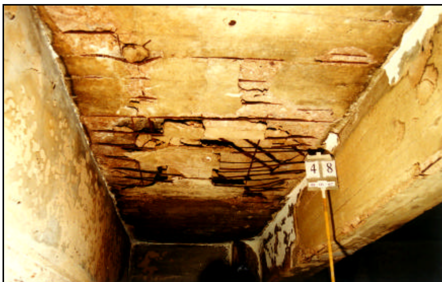
Figura 3.10 - Aparência de uma estrutura tipo laje após um incêndio
