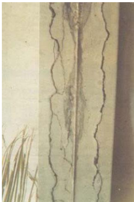
Figura 7 - Corrosão em pilar de concreto por ataque de cloretos
