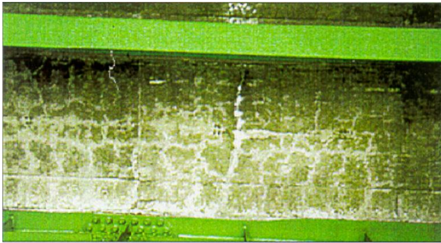
Figura 13 – Fissuramento intenso visto pelo lado inferior do pavimento em concreto com aberturas entre 0,1 a 0,2 mm (MORI, KURAMOTO, et al. , 1996, p. 344)
