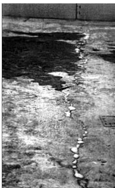
Figura 5 – Fotografia do preenchimento da fissura com o adesivo de reparo incorporado no concreto do pavimento de ponte (DRY, 2000, p. 1975)
