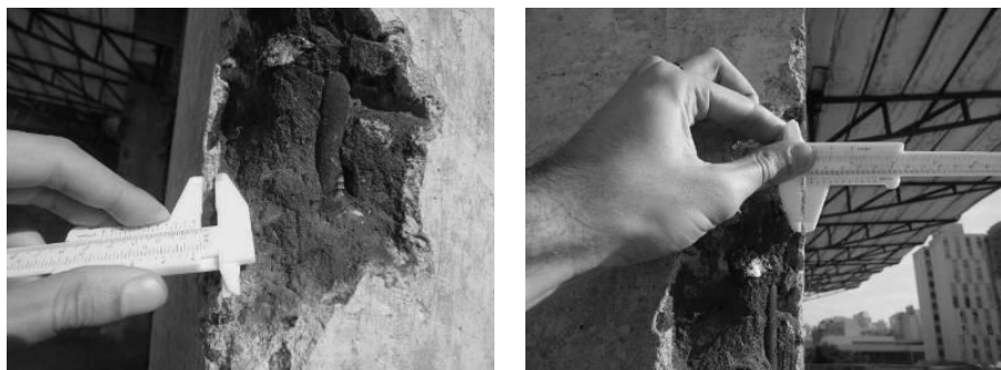
Figura 3 - Medição da profundidade de carbonatação em pilar de fachada.
