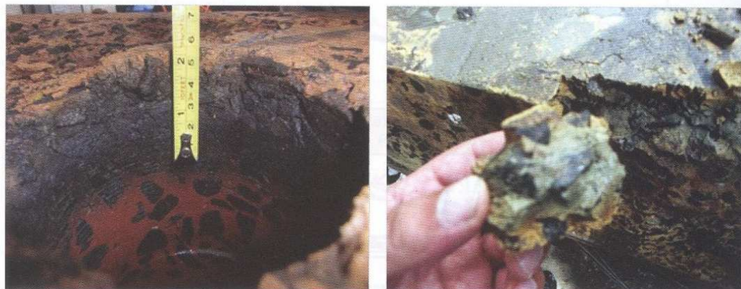
Figura 10 – Índice colorimétrico promovido no interior do pilar devido à transformação química de redução, ocorrida com o calor, do óxido de ferro ( Fe_2O_3 ): escura no interior do centro das faces e alaranjada na superfície das faces e profundidade das arestas
