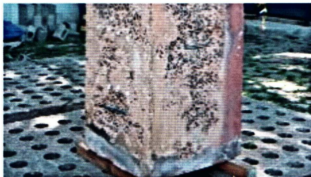
Detalhe mostra os danos causados pelo fogo. Armadura ficou pouco exposta.
