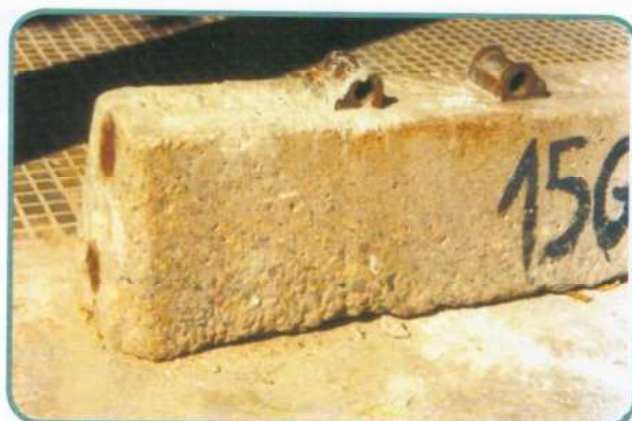
Fig 08 - Detalhe do desgaste superficial de um dormente
