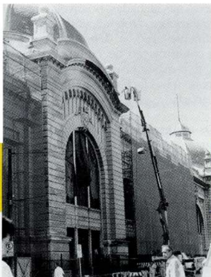
Foto 2 Descolamento e desagregação do revestimento na fachada
