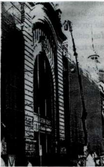
Foto 3.1 - Fachadas com descolamento do revestimento
