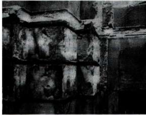
Foto 3.2 - Detalhe do descolamento e desagregação do revestimento
