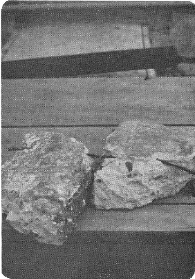
Foto 9. — Trozos de una placa de cubierta donde se nota claramente el corte de la armadura por corrosión acentuada. El hecho ocurre preponderantemente acompañando la fisura de la placa. Se trata de un trozo de placa, retirado cuando su demolición con fines de recuperación.
