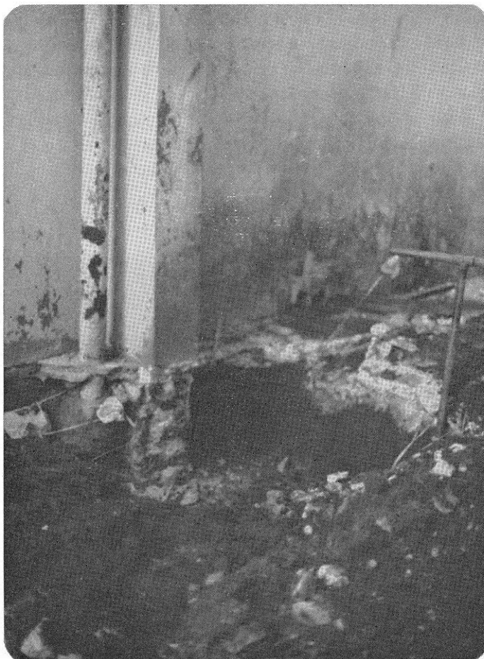
Foto 12.— Corrosión y degradación de estructuras de hormigón armado en ambientes industriales. Los gases y líquidos ácidos (proceso de galvanoplastia) que penetran en el piso y suelo destruyeron el hormigón y parte de la estructura. Nótese la comprobación de la alcalinidad con auxilio de la fenolftaleína, apreciándose trechos alcalinos alternando con trechos ácidos.
